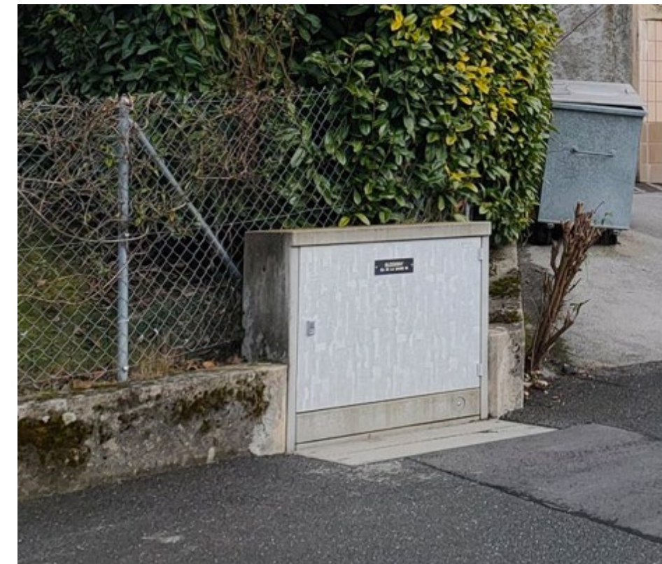
Ex : Armoire basse tension
